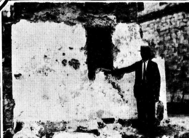
Durante los trabajos de demolición que se realizan a la entrada del puerto, fué descubierto en un viejo muro del Castillo de la Fuerza este nicho conteniendo restos humanos.
